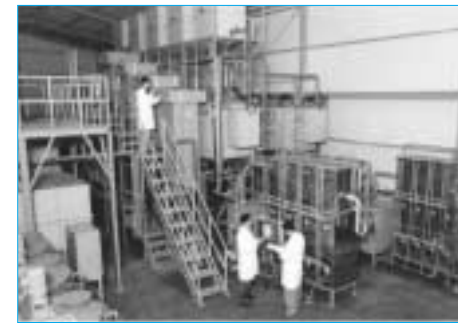
〈그림 4〉 자동제어장치가 설치된 파일릿플랜트
