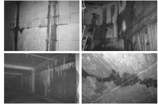
〈사진 1〉 콘크리트 구조물의 누수 현상
